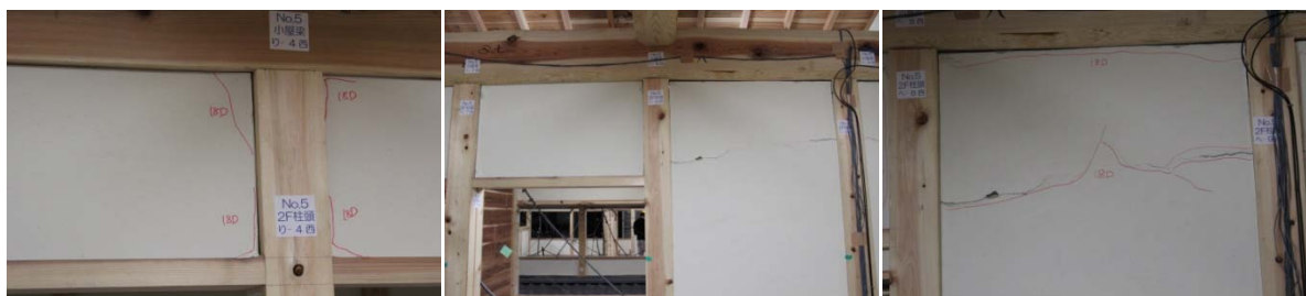
図 2.3.5-9 加振 D 後の 2 階内部の損傷観察
