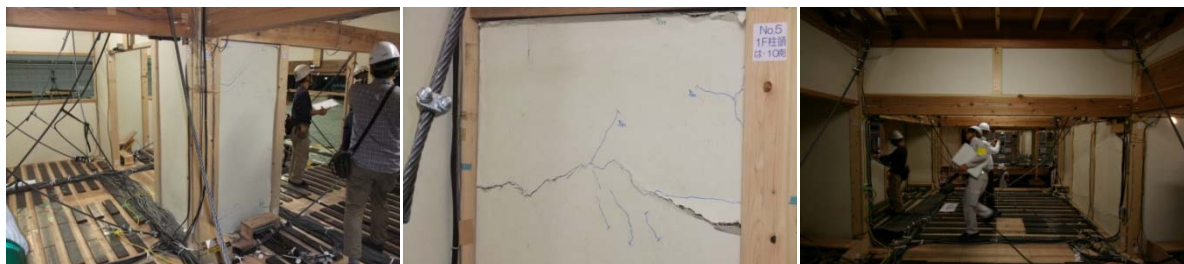
図 2.3.5-4 加振 C 後の 1 階内部の損傷観察
