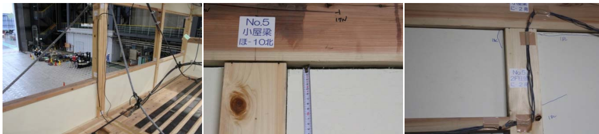
図 2.3.5-5 加振 C 後の 2 階内部の損傷観察
