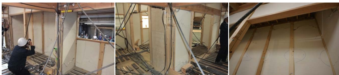
図 2.3.5-11 加振 E および F 後の 1 階内部の損傷観察
