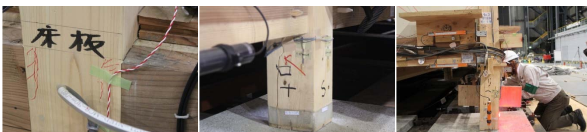
図 2.3.5-7 加振 D 後の柱脚部の損傷観察
