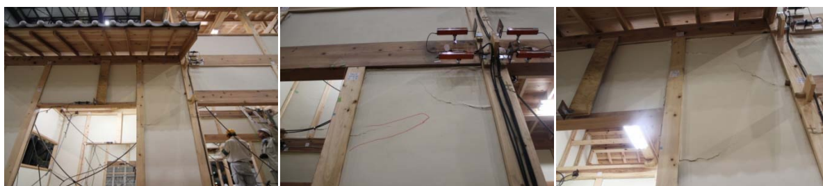
図 2.3.5-10 加振 D 後の外部の損傷観察
