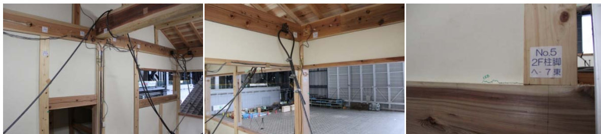
図 2.3.5-2 加振 A、加振 B 後の 2 階内部の損傷観察
