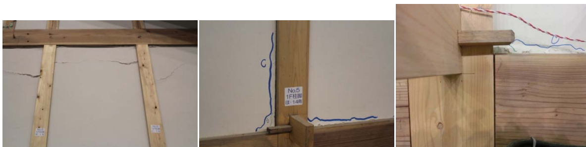
図 2.3.5-6 加振 C 後の外部の損傷観察
