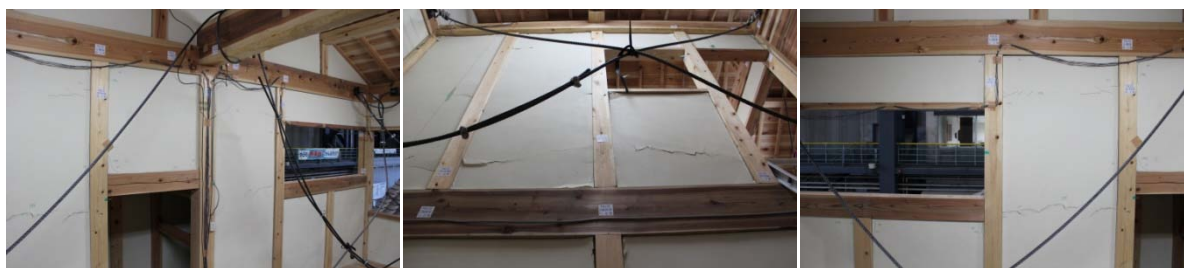
図 2.3.5-12 加振 E および F 後の 2 階内部の損傷観察
