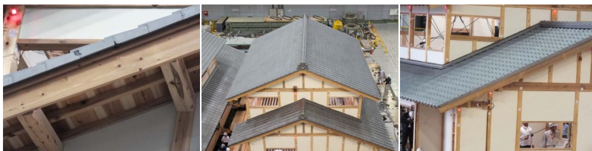
図 2.3.5-14 加振 E および F 後の屋根瓦の損傷観察
