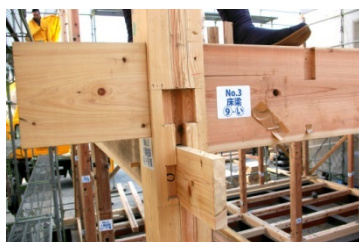
仕口解体時、雇いなど損傷無し 写真 05 い-9, 通し柱・床梁
