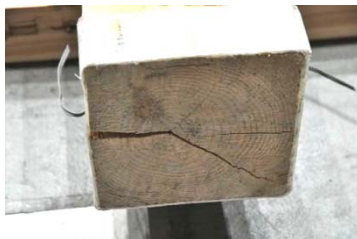
リ-5 柱脚乾燥割れ拡大 写真 03 リ-5 柱脚底割れ拡大
