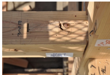
隙間が拡大し雇い部分折損 写真 02 い-1 雇いの損傷
