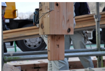
土台ほぞ、込み栓穴から亀裂 写真 04 い-1, 柱ほぞの亀裂
