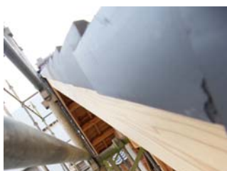
袖瓦ずれ、袖部分の目欠け 写真 01 1 通側、袖瓦
