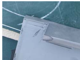
袖瓦目欠け 写真 08 13 通側袖瓦、は通付近
