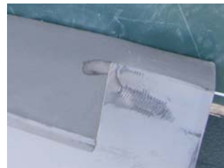
袖瓦目欠け 写真 09 1 通側袖瓦、ろ通付近
