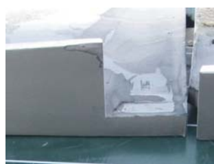
袖瓦目欠け 写真 07 13 通側袖瓦、ろ通付近
