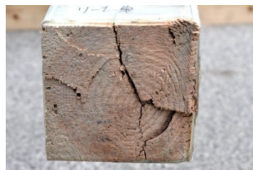
柱の底から見た折損の状況 写真 08 り-1, 通し柱柱脚(裏)
