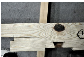
仕口端部から亀裂拡大 写真 05 ホ通中引き, 9 通端
