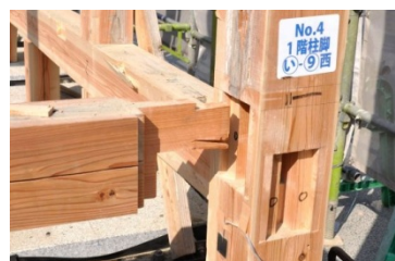
柱脚足固め小根ほぞの折損 写真 04 い-9 柱脚足固め仕口
