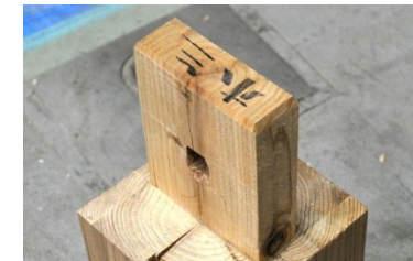
床束ほぞ、ほぞ穴より亀裂 写真 08 ホ-3, 床束ほぞ
