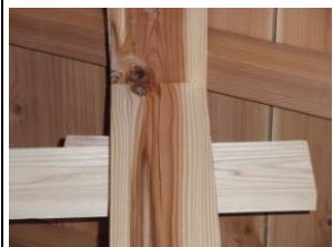
写真8 小屋貫くさび抜け
