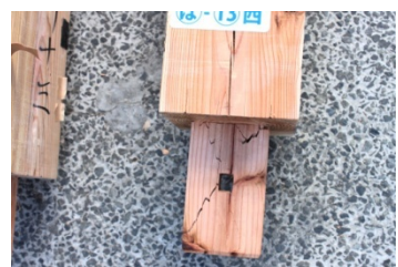
通し柱柱脚ほぞ弱軸折損 写真 07 ほ-13 柱脚ほぞ折損
