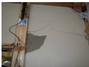
写真1 1階土壁剥落 ほ-1～2
