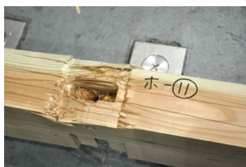
ホ-11 床束ほぞ圧壊(下端撮影) 写真 02 ホ通足固め, ホ-11
