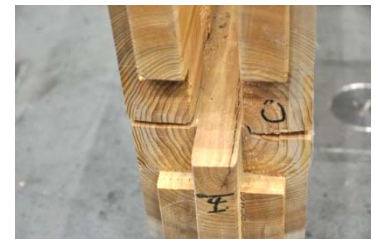
仕口部分より乾燥割れ拡大 写真 05 5通足固め, ホ～リ間
