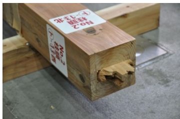
ト-13 柱頭、ほぞ折損 写真 04 ト-13 管柱頭ほぞ折損
