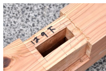
足固め床束ほぞの圧壊・亀裂 写真 09 は-9 足固め・床束
