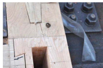
土台, 鎌部分男木女木共に亀裂 写真 09 り通土台, リ-5 継手
