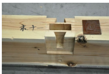
蟻, 柱脚ほぞ隅から亀裂拡大 写真 01 ホ通足固め, ホ-11
