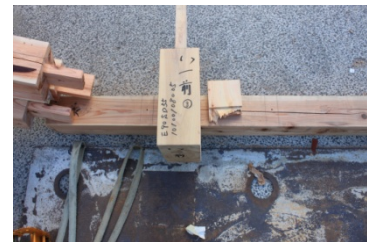
雇い部分折損 写真 03 い-1 雇いの損傷
