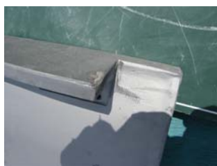
袖瓦目欠け 写真 07 13 通側袖瓦、ち通付近
