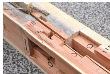
2 階仕口は西側で亀裂 写真 03 い-5, 2 階, 通し柱
