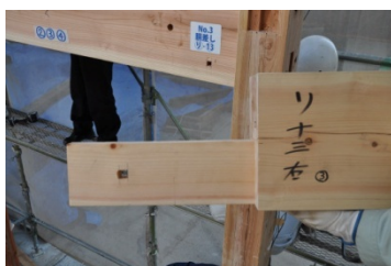
雇いほぞ損傷無し 写真 05 リ-13 雇いほぞ
