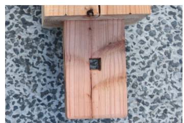
通し柱柱脚ほぞ亀裂 写真 07 い-5 柱脚ほぞ亀裂
