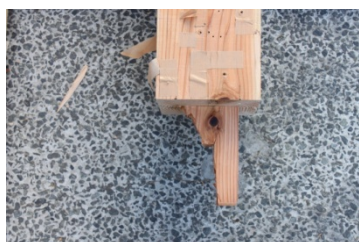
通し柱柱脚ほぞ弱軸折損 写真 04 い-13 柱脚ほぞ折損
