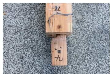
通し柱柱脚ほぞ弱軸折損 写真 07 い-9 柱脚ほぞの折損
