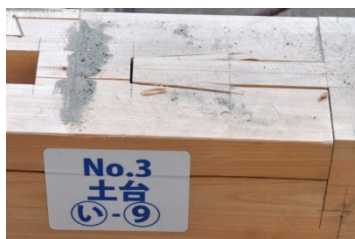
土台, 鎌部分男木女木共に亀裂 写真 08 い通土台, い-9 継手
