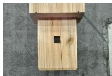
ト-9 柱脚、ほぞ亀裂 写真 03 ト-9 管柱脚ほぞ亀裂
