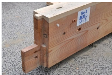
包込ほぞ差し込み栓打, 損傷無し 写真 05 い-1. 胴差し仕口
