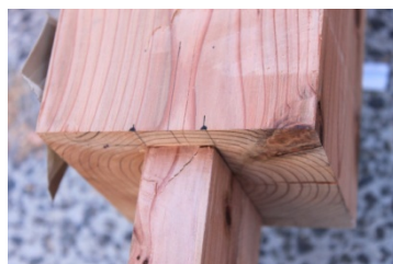
1 階管柱, 柱脚ほぞ折損 写真 09 は-13 柱脚ほぞ折損
