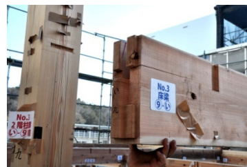
仕口部分襟下端亀裂 写真 03 9 通床梁, い通端
