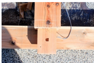
通し柱柱脚ほぞ亀裂 写真 08 ほ-5 柱脚ほぞ亀裂
