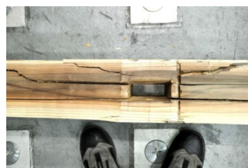
リ-11 床束ほぞ圧壊(下端撮影) 写真 03 リ通足固め, リ-11
