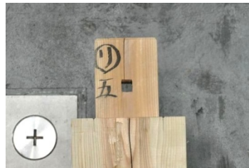
リ-5 柱頭、ほぞ亀裂 写真 02 リ-5 柱頭ほぞ折損亀裂
