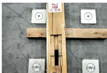
足固め仕口周囲の乾燥割れ拡大 写真 02 リ-9 柱脚仕口割れ
