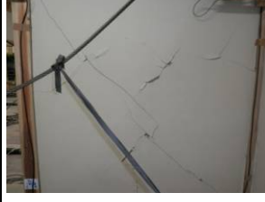
写真3 1階壁亀裂 9-と～り
