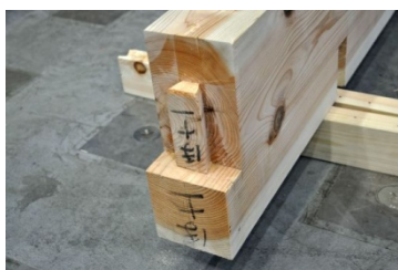
ささらは部材, 仕口共傷無し 写真 01 11通ささら, ほ側仕口
