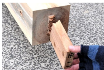
通し柱柱頭ほぞ折損 写真 04 い-5, 通し柱柱頭
