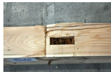
は-13 ほぞ折損めり込み(下端撮影) 写真 07 13通足固めほ～り間
