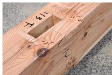
床束ほぞの圧壊・亀裂（下端撮影） 写真 08 り-13 足固め・床束
