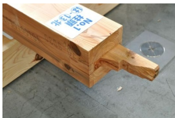
は-13 柱頭、ほぞ折損 写真 05 は-13 柱頭ほぞ折損
