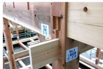
胴差し仕口, 雇い等損傷無し 写真 03 り通, 通柱, 胴差し解体
