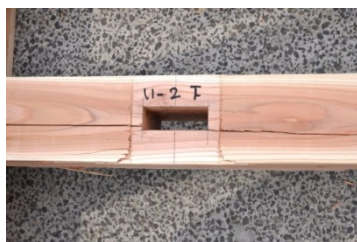
床束はその圧壊・亀裂(下端撮影) 写真 08 い-2 足固め・床束
