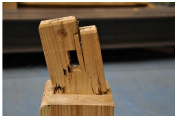
床束ほぞ折損 (短辺方向へ変形) 写真 08 ト-9, 床束ほぞ
