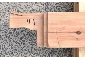
足固め小根ほぞ割くさび折損 写真 06 り通足固め 1 通り仕口
