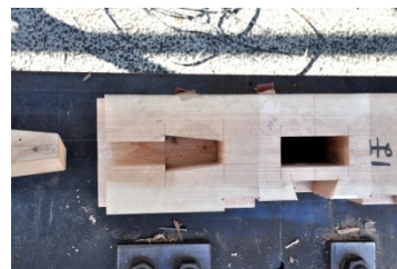
土台部分鎌女木より亀裂 写真 03 13 通土台, ほ通脇
