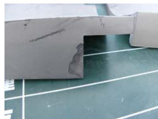
袖瓦目欠け 写真 08 1 通側袖瓦、ろ通付近
