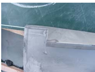
袖瓦目欠け 写真 05 1 通側袖瓦、ち通付近
