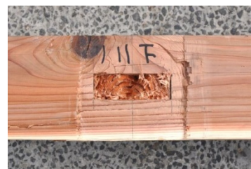
床束ほぞの圧壊・亀裂（下端撮影） 写真 09 り-11 足固め・床束
