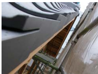
袖瓦ずれ、大きな損傷は無い 写真 01 13 通側、袖瓦
