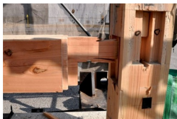
足固め小根ほぞ割くさび折損 写真 07 い-1, 足固め仕口
