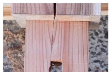
1 階管柱柱脚ほぞ亀裂(拡大) 写真 07 い-11 柱脚ほぞ亀裂
