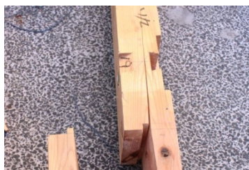
入隅部分亀裂を拡大 写真 02 い通桁, 9 通継手
