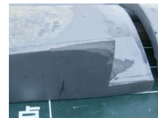
袖瓦目欠け 写真 09 1 通側袖瓦、ち通付近
