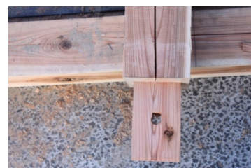
1 階管柱柱脚ほぞ亀裂 写真 06 い-11 柱脚ほぞ亀裂
