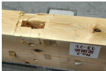
ハ-13 柱脚ほぞ部分圧壊 写真 05 13 通足固めイ～木間
