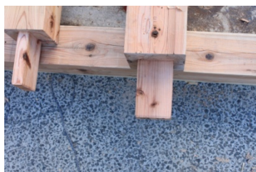
通し柱柱脚ほぞ亀裂 写真 08 ほ-9 柱脚ほぞ亀裂
