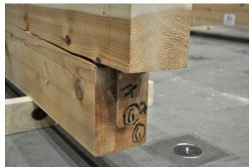
仕口部分より乾燥割れ拡大 写真 04 7通ささら, ホ～リ間
