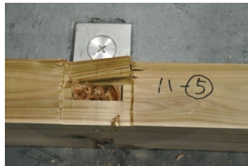
ハ-5 ほぞ折損, めり込み (下端撮影) 写真 07 5通足固めイ～ハ間
