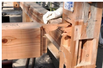
柱脚足固め小根ほぞの折損 写真 08 い-5 柱脚足固め仕口
