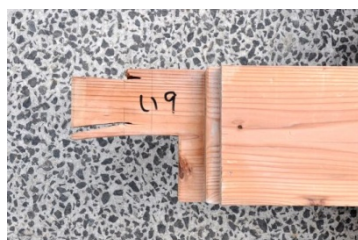
柱脚足固め小根ほぞの折損 写真 05 い-9, 足固め仕口
