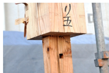
柱脚ほぞの弱軸側の折損 写真 06 り-5 柱脚ほぞの折損
