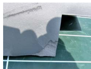
袖瓦目欠け 写真 06 13 通側袖瓦、ち通付近
