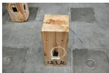
床束ほぞ、ほぞ折損 写真 06 は-1, 床束ほぞ
