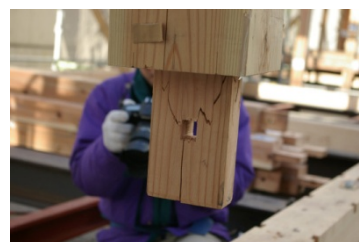
柱脚ほぞの弱軸側の折損 写真 06 り-9 柱脚ほぞの折損
