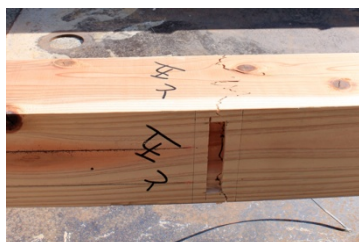
小壁下端で管柱折損 写真 05 と-5, 2 階管柱折損
