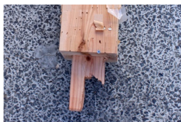
通し柱柱脚ほぞ弱軸折損 写真 05 り-13 柱脚ほぞ折損
