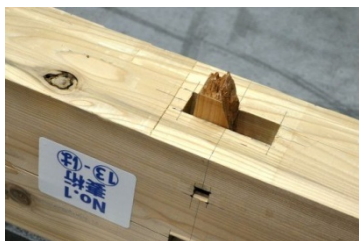
は-13 柱頭、ほぞ折損(下端撮影) 写真 04 13通床梁ほ～り間
