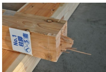
～5 柱脚、ほぞ折損 写真 04 へ～5 柱脚ほぞ折損
