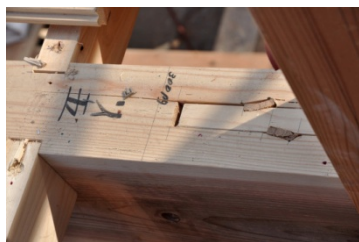
雇いめり込み、車知栓上部圧壊 写真 02 5 通床梁、り通端
