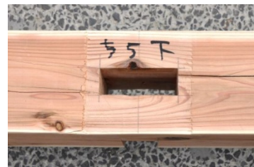
足固めほぞのめり込み（下端側撮影） 写真 09 5 通足固め、ち-5 仕口
