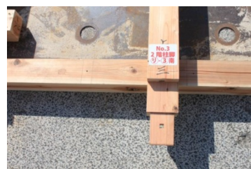
2階管柱柱脚ほぞ損傷無し 写真 06 リ-3, 2 階柱脚ほぞ
