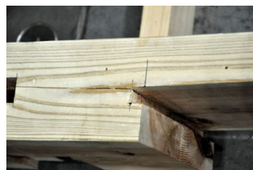
仕口端部から亀裂拡大(下端撮影) 写真 06 ホ通中引き, 9 通端
