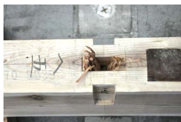
～5 柱脚、ほぞ折損 写真 03 5通足固めほ～り間
