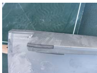
袖瓦目欠け 写真 06 1 通側袖瓦、ち通付近
