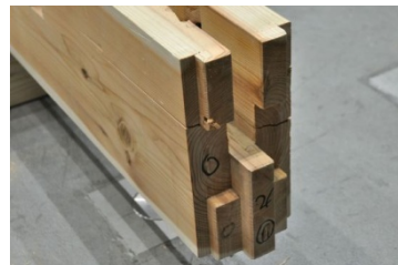
足固め 9 通側仕口乾燥割れ拡大 写真 06 9 通足固めイ～木間
