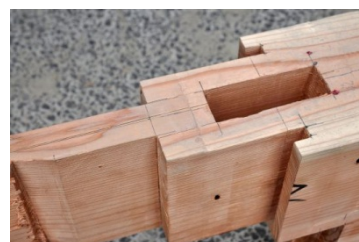
ほ通、男木竿入隅から微小亀裂 写真 06 ほ-5, 床張り継手
