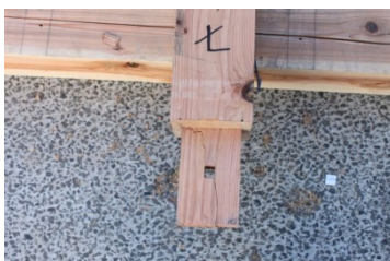
1階管柱柱脚ほぞ穴亀裂 写真 08 リ-7, 1 階柱脚ほぞ
