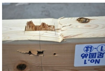
～5 ほぞ折損, めり込み(下端撮影) 写真 07 1通足固めほ～り間
