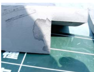
袖瓦目欠け 写真 05 13 通側袖瓦、ち通付近
