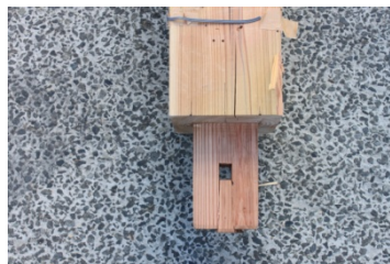
土台ほぞ、込み栓穴から亀裂 写真 05 り-1, 柱ほぞの亀裂
