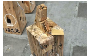
床束ほぞ、ほぞ折損 写真 09 と-9, 床束ほぞ
