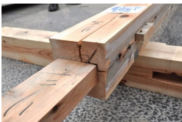
ほぞ入隅で乾燥割れ亀裂へ拡大 写真 05 り-3、1 階管柱柱頭
