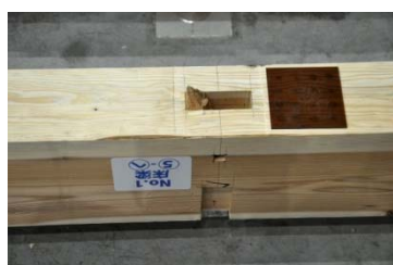
～5 柱頭、ほぞ折損(下端撮影) 写真 01 5通床梁ほ～り間
