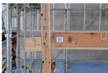
ほ-1 と 雇いほぞ損傷無し 写真 02 ほ通中引き、ほ-1 仕口
