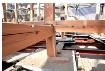
足固め床束ほぞの圧壊・亀裂 写真 08 は-9 足固め・床束
