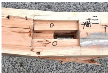
柱脚仕口で折損 写真 07 り-1, 通し柱柱脚(東)
