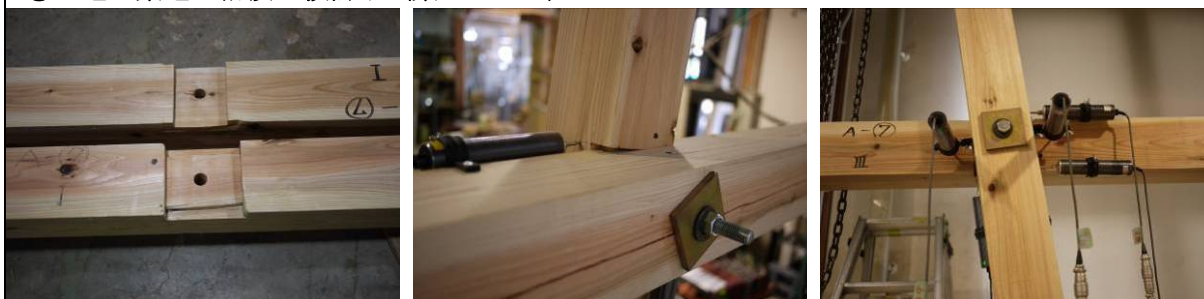
A⑦-1 内部のめり込み変形
