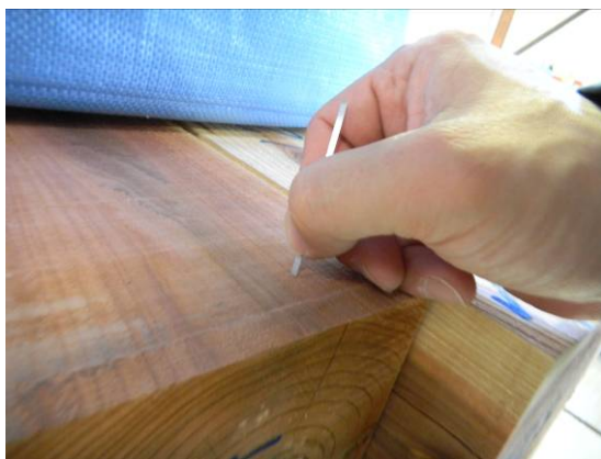
d) 割れ最深部の探査
