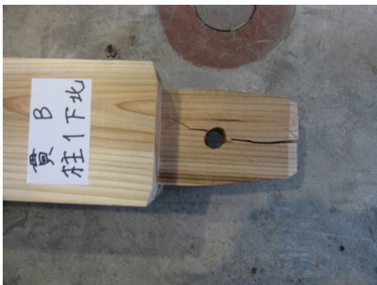
写真 6. 2. 1-4 柱ほぞの割れ
