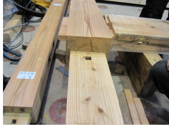
写真 6. 3. 1-7 柱頭部木口の割れ
