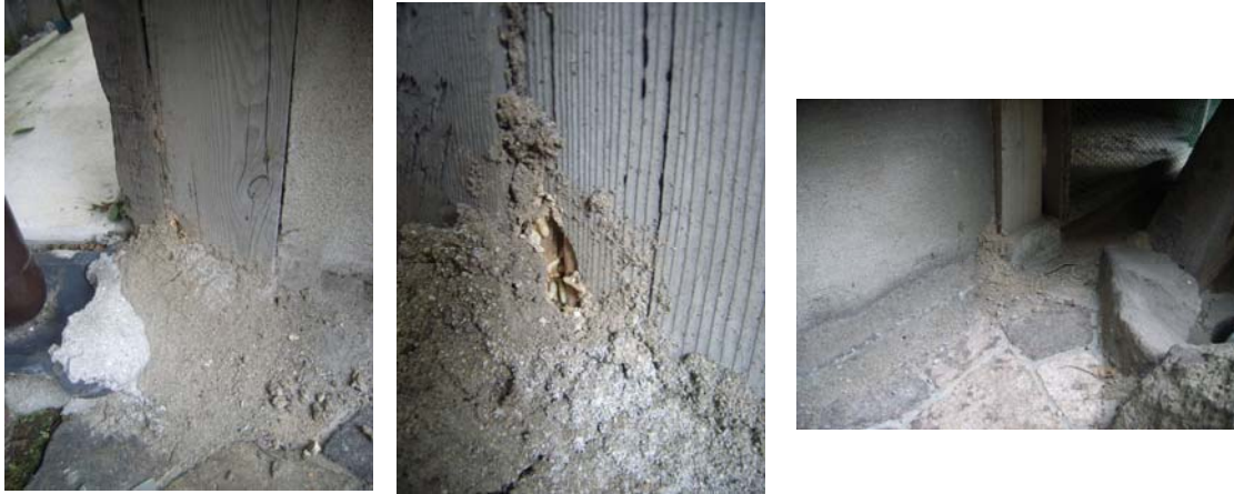
写真 6. 6. 2-19 外壁の柱で発見された蟻土（左右）と内部を食害するシロアリ（イエシロアリ）（シロアリの確認は 2007 年 11 月）
