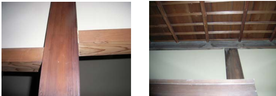
写真 6. 6. 2-20 室内側でのシロアリ食害（蟻土）と縁側での雨漏りの状況
