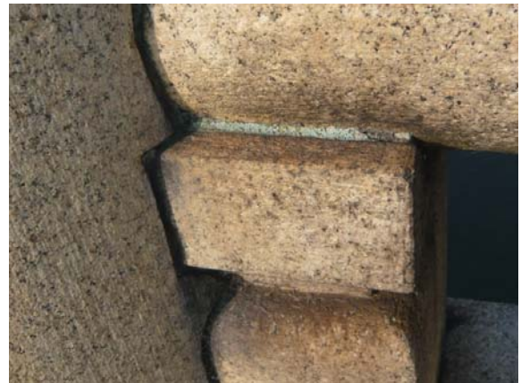
写真 6. 6. 4. -9 接合部付近の溝の水色の析出物(銅化合物か?)
