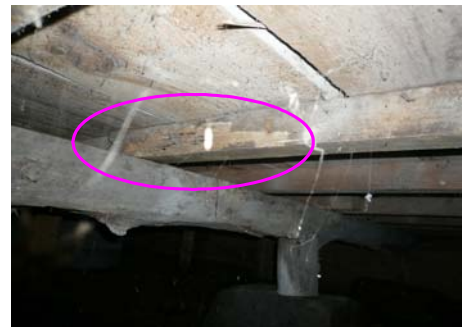
写真 6. 6. 2-4 床下・根太材のシロアリ食害
