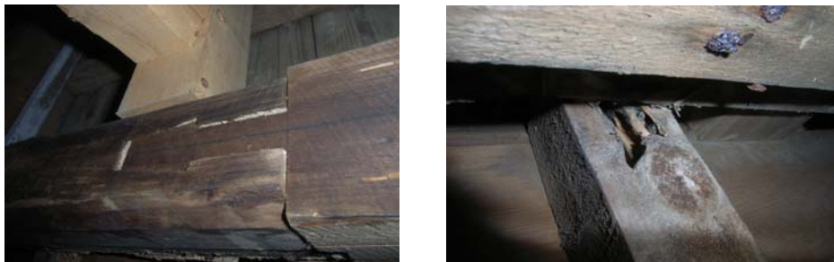
写真 6. 6. 2-21 玄関周囲の床下部材のシロアリ食害 左：接合部に詰まった蟻道、右：床束内部の蟻道
