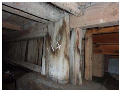
写真 6. 6. 1-5 農家造建物の床下の劣化例
