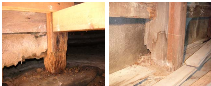
写真 6. 6. 1-1 長期間にわたり柱の足元に進行した生物劣化
