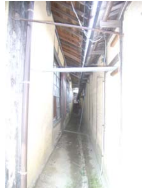
写真 6. 6. 2-9 建物外観と北側底部の状況
