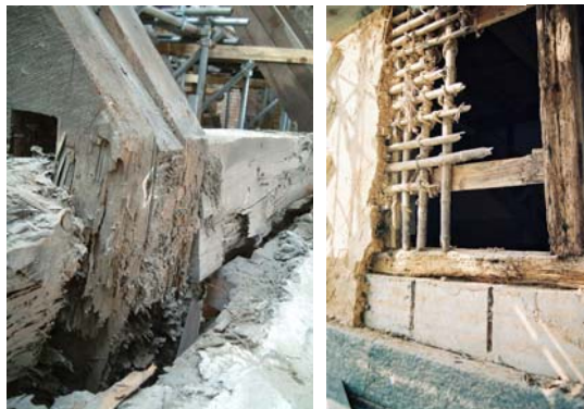
写真6. 6. 1-3 レンガ造の小屋束（左）や土蔵の構造材（右）の劣化事例 左では底がなく雨仕舞いが悪いため雨水の浸潤と滞留がおき、腐朽とヤマトシロアリ食害が発生している（京都市、重文）。右は土蔵の大壁の内部に雨水が浸潤し、腐朽とシロアリ食害が発生している（萩市、重文）
