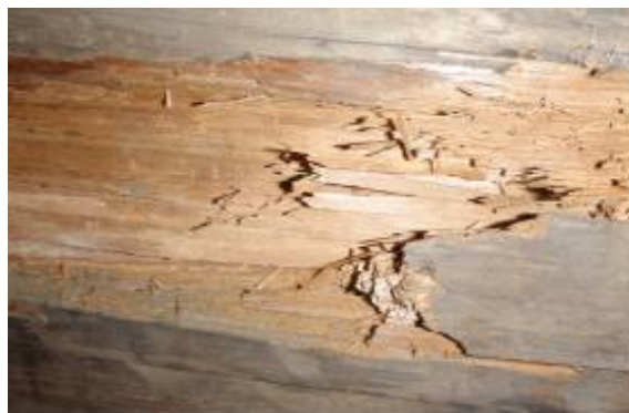
写真 6. 7. 3-4 蟻害が見つかった梁
