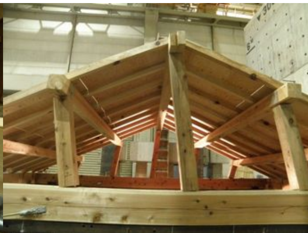
写真3. 4. 1-33 小屋束の傾斜 (RGPO)
