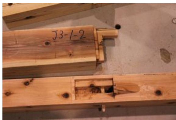
写真3. 4. 2-59 込み栓から折れ (J3-1-2)
