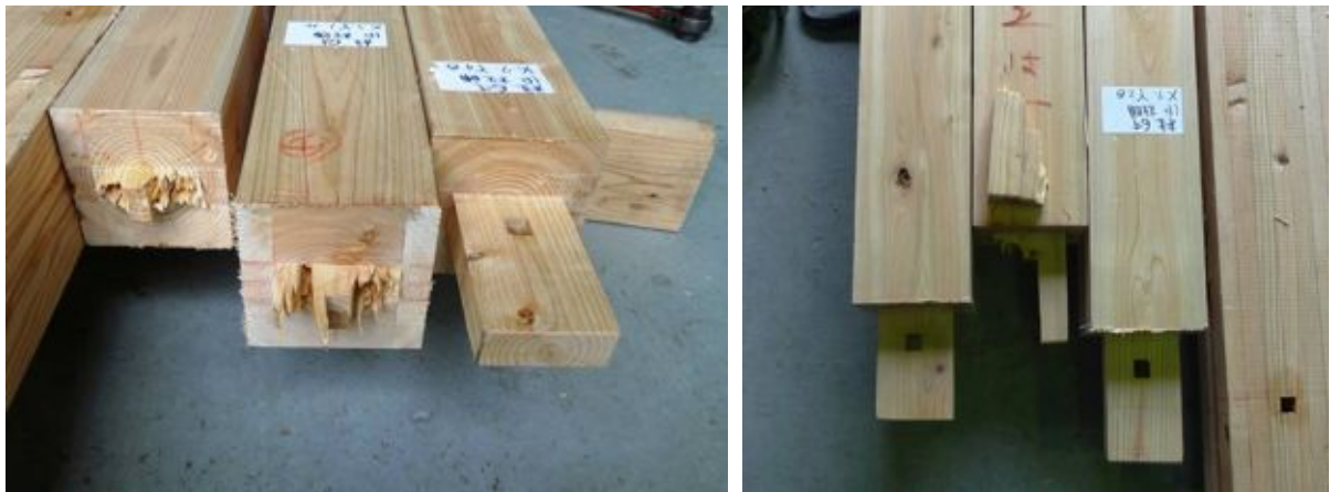
写真3. 3. 3-15 柱の損傷状況（左：柱頭部、右：柱脚部）
