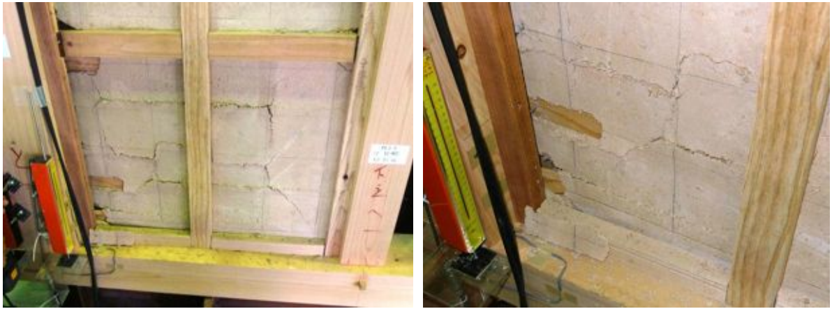
写真3. 3. 3-14 700cm/s 2 後の乾式土壁パネルの損傷状況
