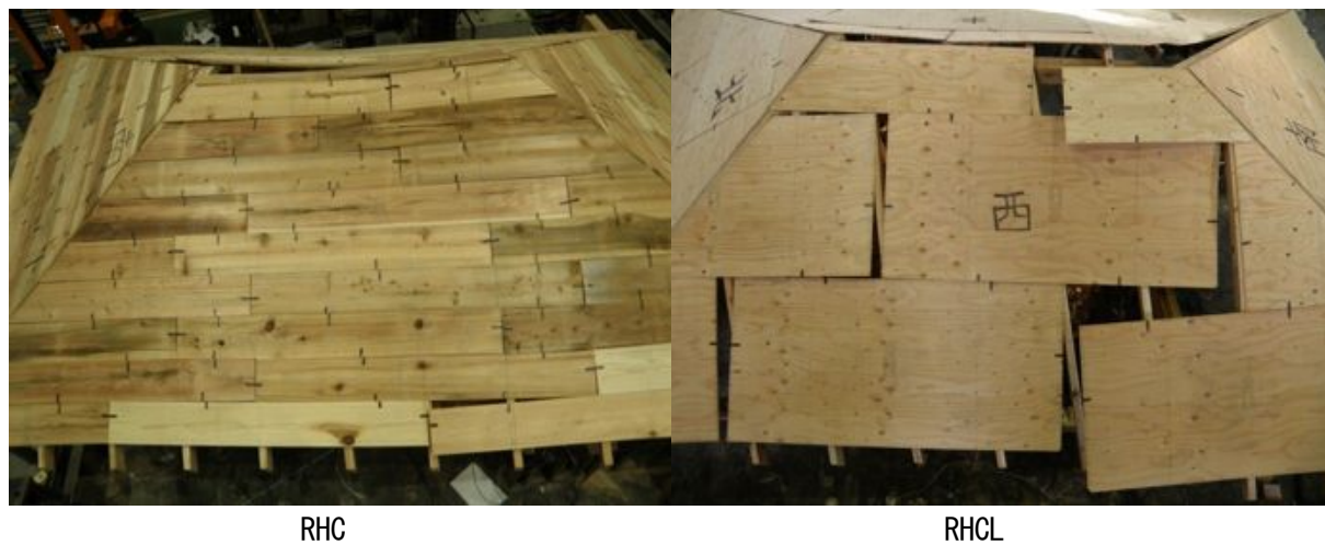
写真3. 4. 1-48 野地板の変形
