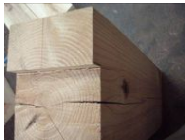
写真3. 4. 2-103 E1-6損傷状況
