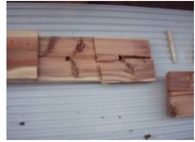
写真3. 4. 2-87 D1-15-2損傷状況
