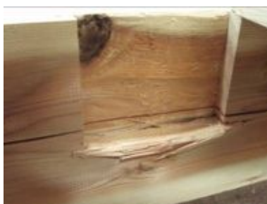
写真3. 4. 2-115 E2-5-6損傷状況
