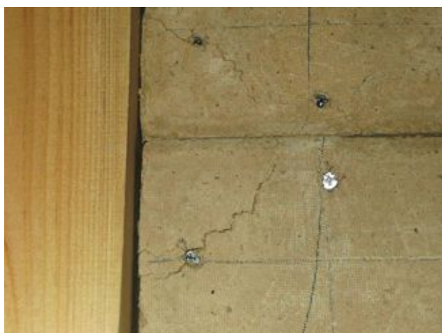
写真3.3.3-12 350cm/s 2 で発生した亀裂
