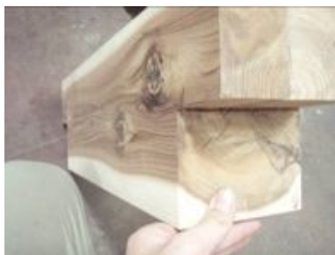
写真3. 4. 2-108 E1-11損傷状況
