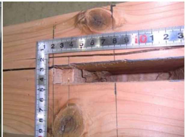
写真3. 4. 2-45 J1No10-3加力後 柱ほぞ孔
