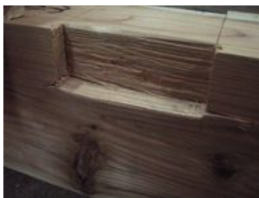
写真3. 4. 2-112 E2-2-3損傷状況
