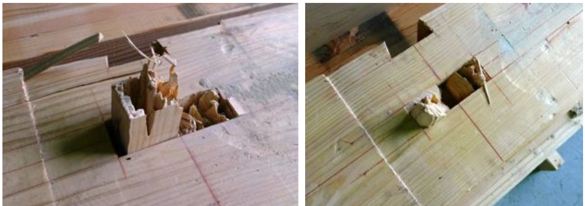
写真3. 3. 3-16 接合部（桁-柱）の損傷状況
