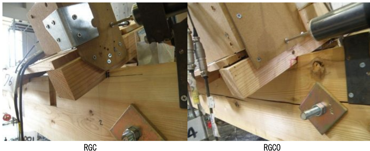
写真3. 4. 1-30 垂木一桁接合部の破壊状況
