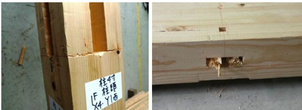
写真3.3.3-10 接合部の損傷状況（左：3方差し、右：桁-柱頭接合部）
