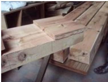
写真3. 4. 2-89 D2-1-2損傷状況
