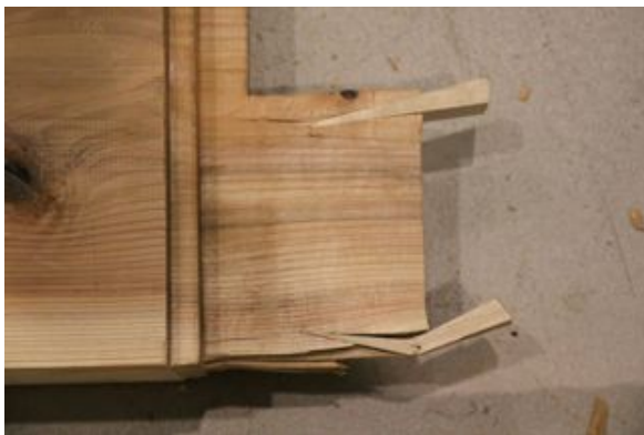
写真3. 4. 2-69 ホゾがめり込み、割れ楔が折れ (J4-4-3)
