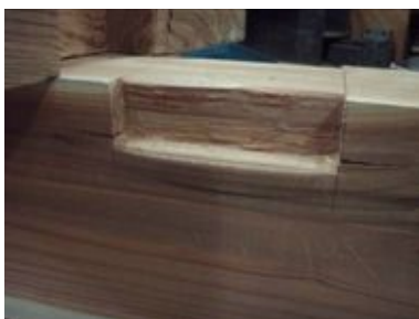
写真3. 4. 2-111 E2-1-1損傷状況
