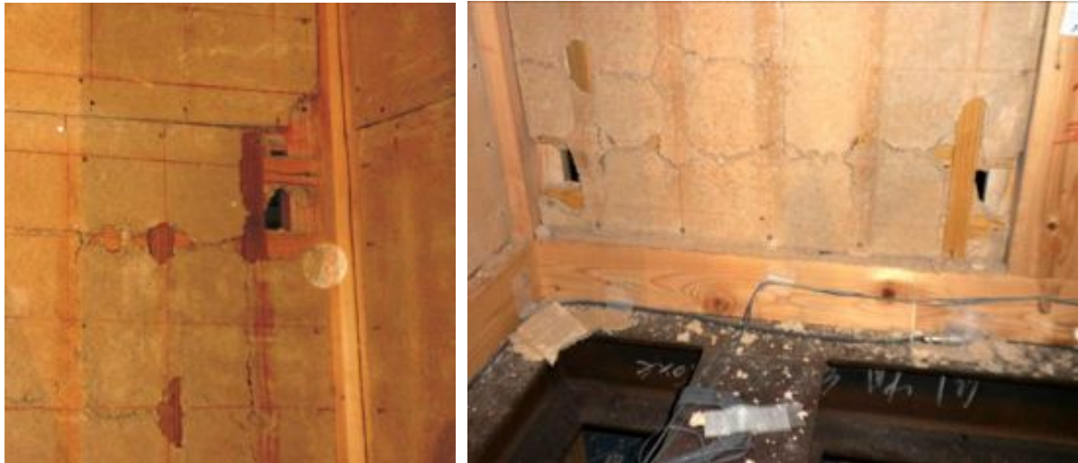
写真3. 3. 3-7 500cm/s 2 後の乾式土壁パネルの損傷状況
