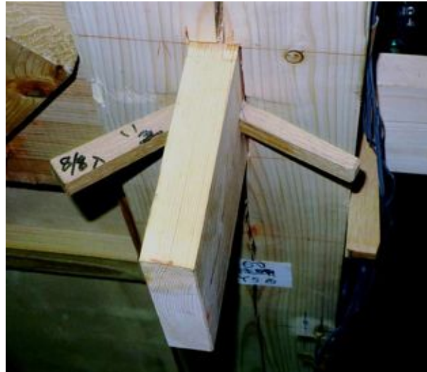
写真3. 3. 3-17 鼻栓の損傷状況（解体前）
