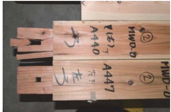
柱ほぞの損傷
