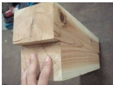
写真3. 4. 2-104 E1-7損傷状況
