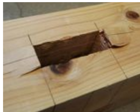
(d) ほぞ穴縁の割れ
