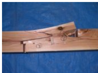
目違いの開きによる割裂き破壊
