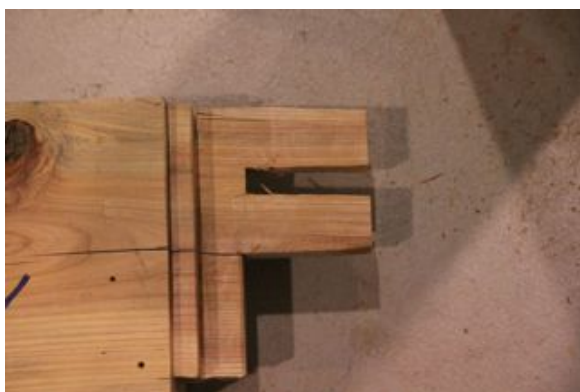
写真3. 4. 2-58 込み栓から割裂 (J3-1-1)
