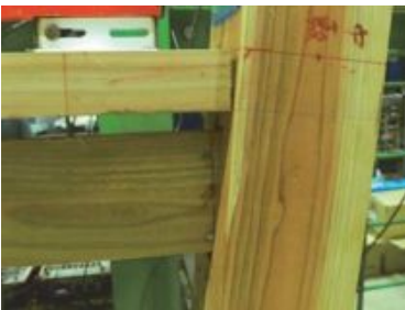
(d) 右側鴨居部分の様子
