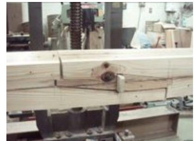
写真3. 4. 2-91 D2-3-3損傷状況
