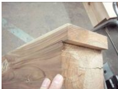
写真3. 4. 2-102 E1-5損傷状況
