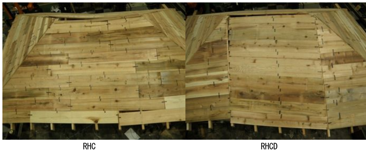
写真3. 4. 1-46 野地板の変形
