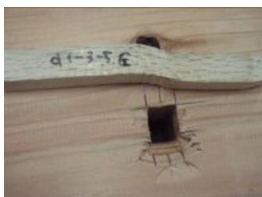
写真3.4.2-96 d' 1-3損傷状況
