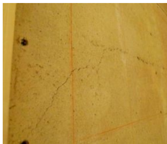
写真3.3.3-13 400cm/s 2 で発生した亀裂
