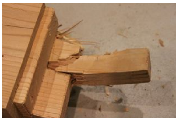
写真3. 4. 2-61 込み栓から折れ (J3-2-3)
