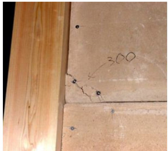
写真3.3.3-6 300cm/s 2 で発生した亀裂
