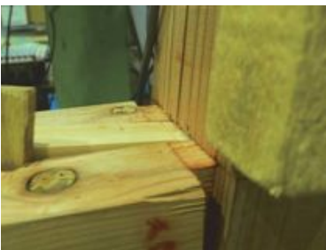
(a) 右側足固めの隙間
