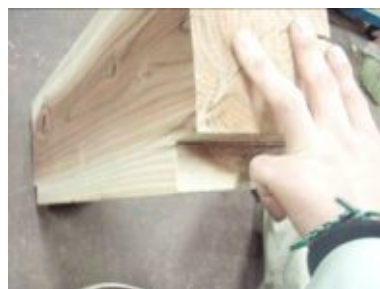
写真3. 4. 2-106 E1-9損傷状況
