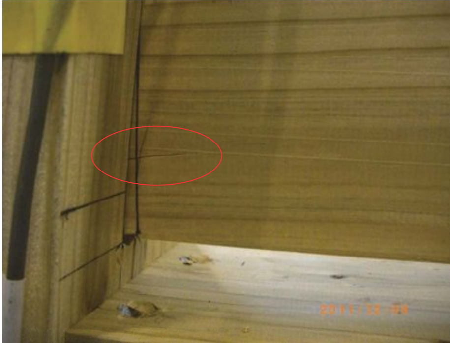
写真3.5.2-10 貫の割れ (MWDF-7、 -1/15\text{rad} )
