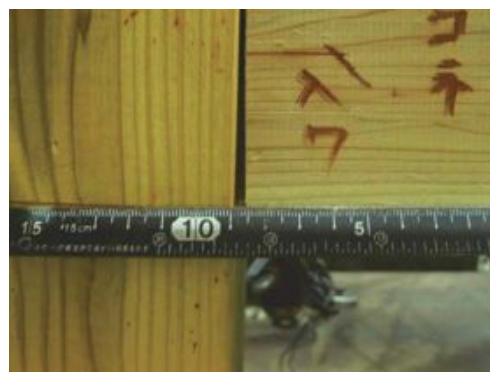
(d) 左柱脚と足固めの隙間
