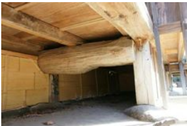
写真 4. 2. 13-9 柱と大引き、雨戸敷居の取り合い
