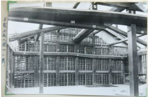
写真4.2.4-14 修理時の記録写真・妻組
