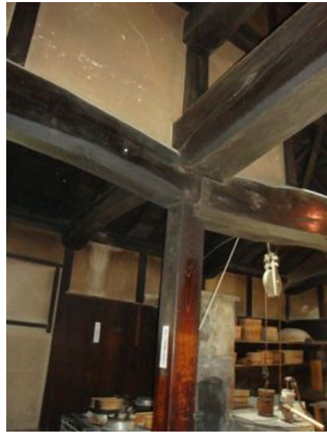
写真4. 2. 5-6 梁巾が広く柱を巻き込むよう
