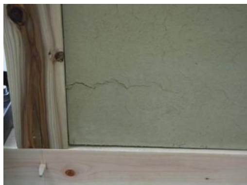
(f) 裏面下貫付近の亀裂(1/60)
