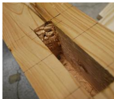
写真 3.4.3-11 鎌を受ける部分の割れ
