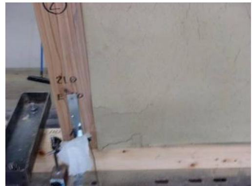
(l) 裏面の面外に出てきた下貫近くの土(1/20)
