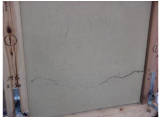
(f) 下貫付近の亀裂の進展 (1/45)
