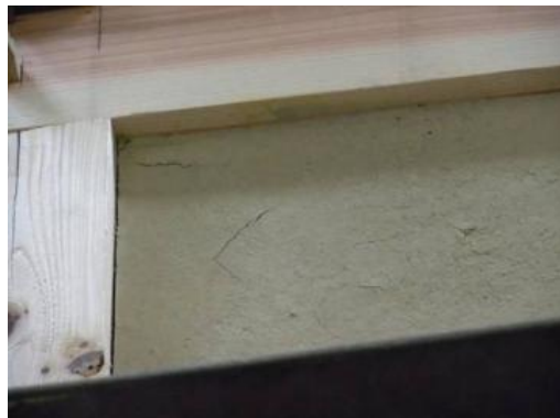
(b) 裏面チリ付近の亀裂(1/120)
