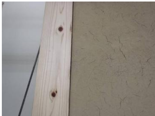
(a) 柱チリ部の隙間(1/120)
