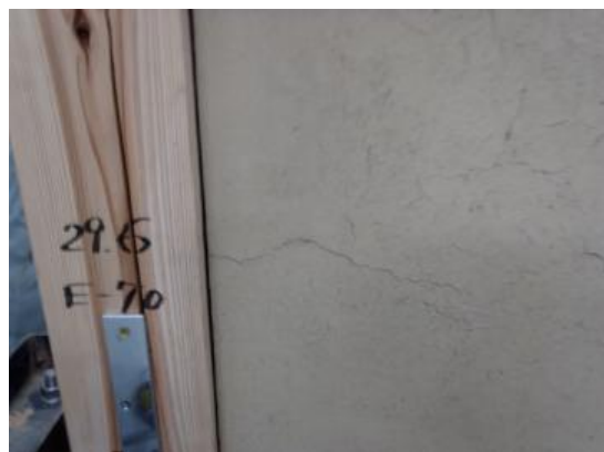
(b) 下貫付近の亀裂(1/120)
