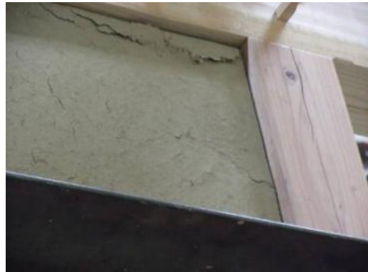
(h) 裏面の上貫付近にも亀裂が発生(1/45)
