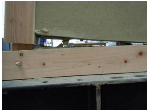
(p) 裏面から見た柱の抜け状況 (1/10)
