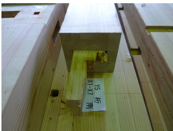
写真 3.3.21 柱脚ほぞの破断
