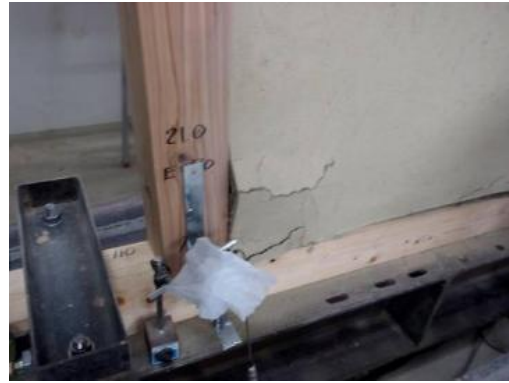
(n) 裏面の下貫近くの土壁の剥がれ (1/15)
