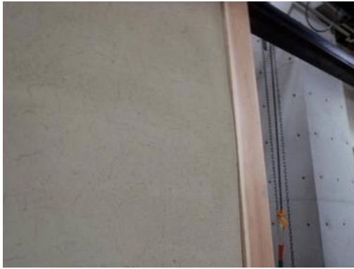
(m) 表面中貫付近の土壁の膨らみ (1/15)
