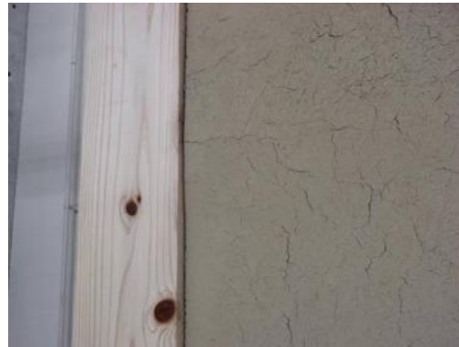
(i) 面外に浮き始めた中貫付近の土壁(1/30)
