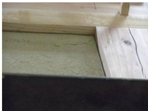
(b) チリ付近の亀裂(1/120)
