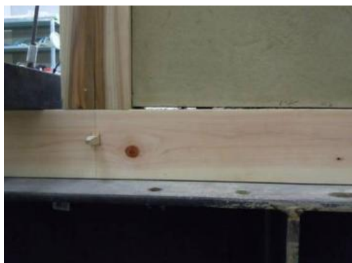
(c) 隅角部の隙間(1/90)
