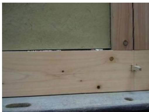
(d) 裏面のチリ部に生じた隙間(1/90) (1/120)
