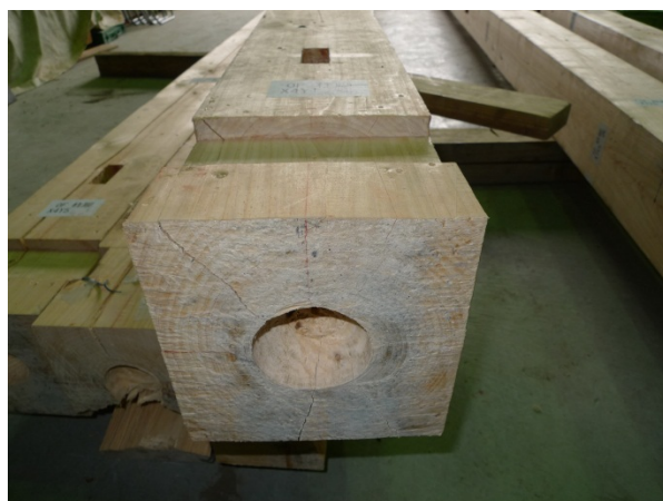
写真 3.3.2-19 解体後の柱底面(X4Y1)
