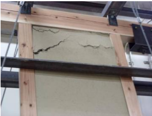
(o) 表面の上貫付近の亀裂の進行 (1/10)
