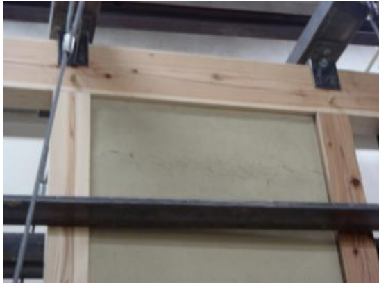
(c) 上貫付近の亀裂が繋がる (1/90)
