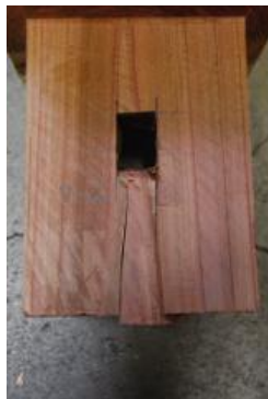
写真 3.4.3-13 ほぞのせん断破壊
