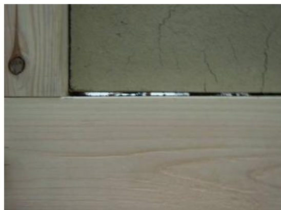
(b) 裏面チリ部の隙間 (1/120)
