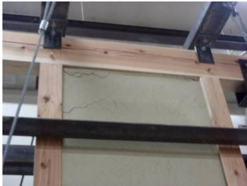
(g) 表面の上貫付近の亀裂(1/45)
