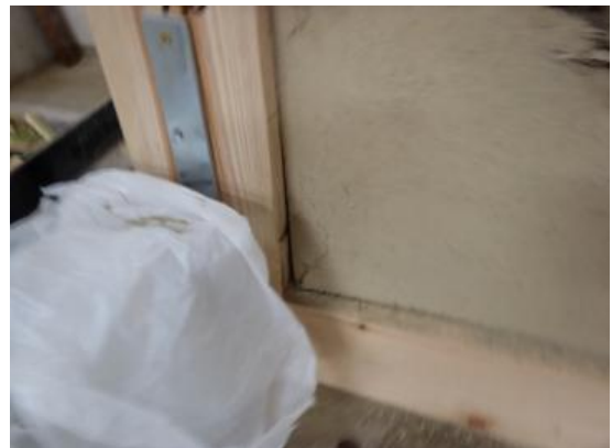
(h) 下隅角部の亀裂と土の剥がれ (1/30)
