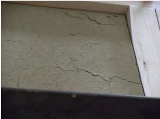
(e) 裏面上貫、チリ付近の亀裂(1/60)
