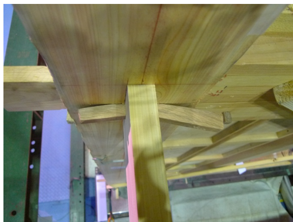
写真 3.3.2-11 胴差接合部の鼻栓の折れ 2
