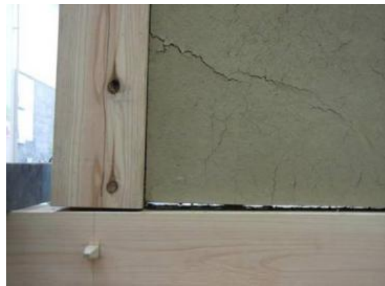
(h) 裏面から見た下隅角部の隙間、亀裂(1/45)
