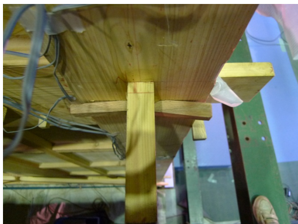
写真 3.3.2-10 胴差接合部の鼻栓の折れ 1
