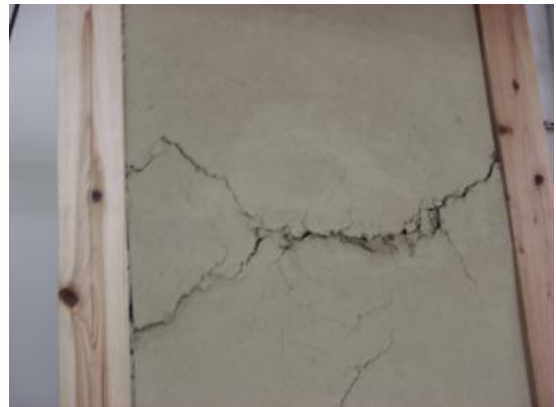
(j) 中貫付近の亀裂の更なる進展 (1/15)
