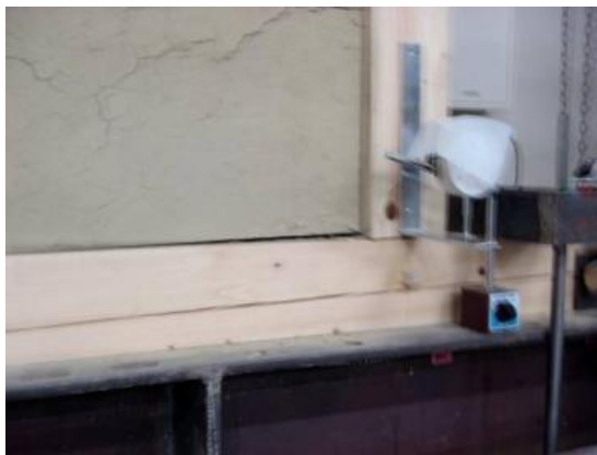
(g) 表面から見た下隅角部の隙間(1/45)
