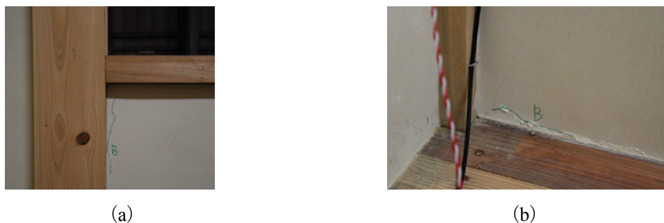
写真 3.2.4-20 加振 B 後の損傷
