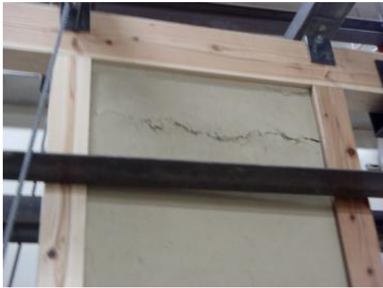
(e) 上貫付近の亀裂の進展 (1/45)
