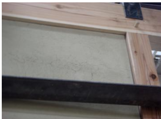
(a) 上貫付近の亀裂(1/120)
