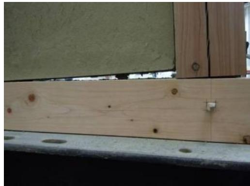
(j) 裏面の下側の隙間の拡がり(1/30)
