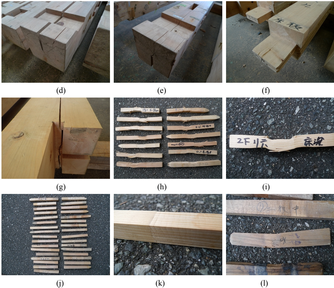
写真9 解体時の損傷観察における各部の損傷
