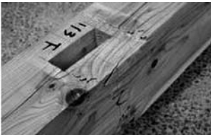
足固めにめり込み（解体時）
