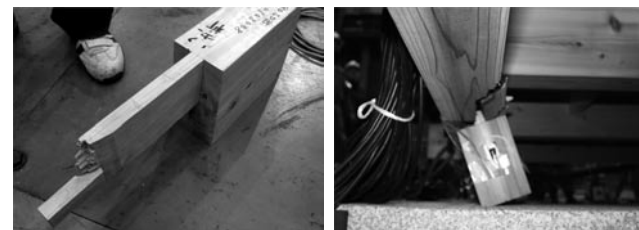
No.1 いー5 竿引き独鈎 No.2 床束の転びと足固め損傷
