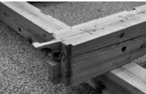
ほぞ損傷（解体時）
