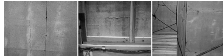
B04：1階壁の割れ
