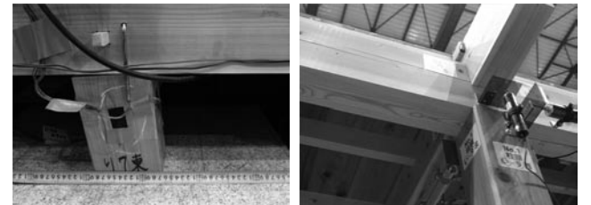
No.1 傾いた床束 No.1 桁にめりこんだ梁
