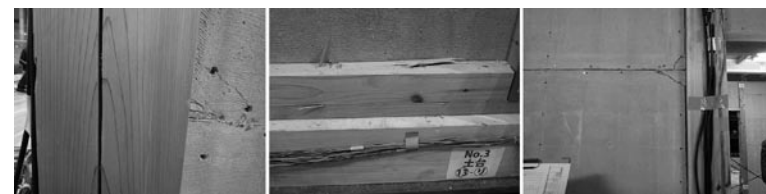
C04：柱の割れ拡大
