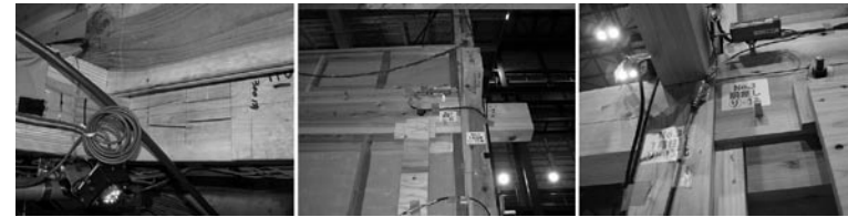
B01：土台継手の割れ
