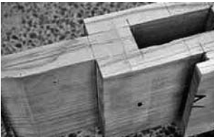
竿部分ひび（解体時）
