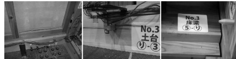
D01：壁受木の割れ
