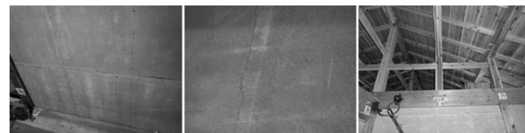
C01：壁のはらみ出し
