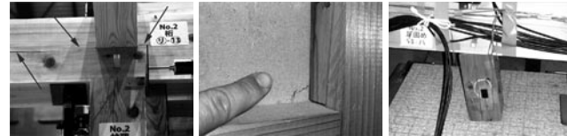
柱と桁の乾燥割れ拡大 壁パネルの隅部圧壊 傾いた床束
